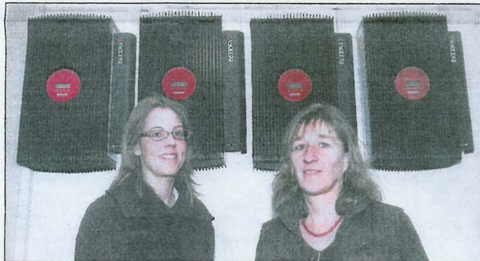
DIE CHEFINNEN Susanne Kötter (links) und Hildegard Siefker begrüßten die ersten Watt auf den Zählern der vier Transformatoren. Fotos: Thomas Niemeyer
